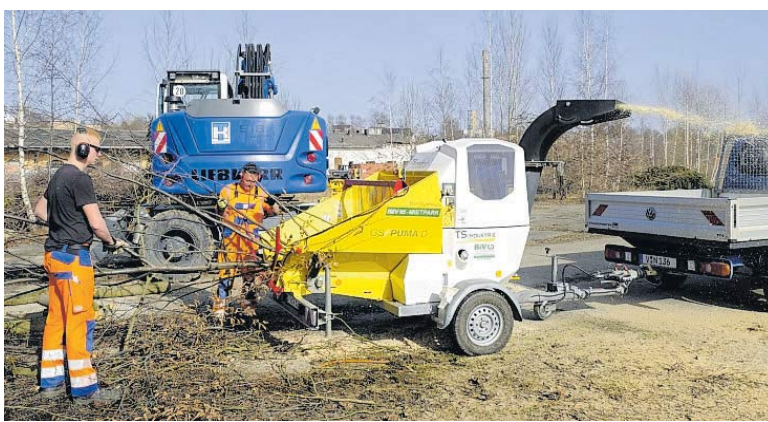
Auch der über die Jahre hochgeschossene Wildwuchs muss weg. Der Auftrag an den Hoch- und Tiefbau Reichenbach.
