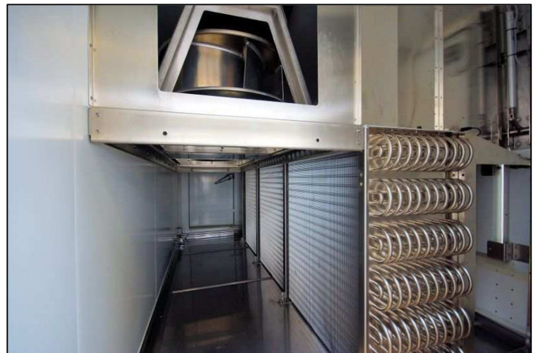
Innenansicht durch die Servicetür eines Isolierkühlers
